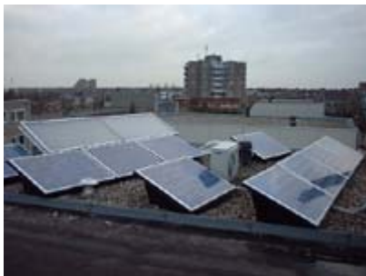
Locatie: Ruimtebaan Zoetermeer Panelen: 10x Shell SRM 105 (Sunpower) Vermogen: 1040 W/piek Omvormers: 10x NKF OKE4
